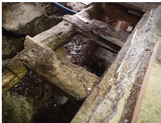
Omfattende råteskader i gulvkonstruksjonen på Fiskebruket.
